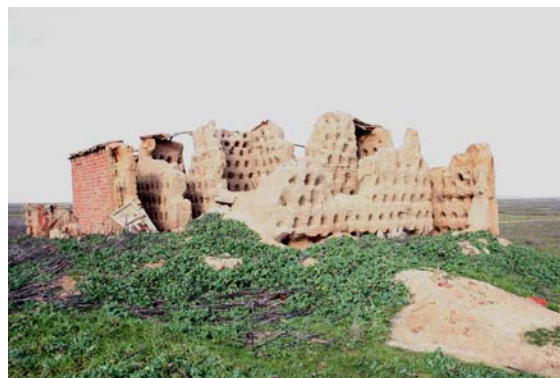
Palomar de barro en avanzado estado de deterioro
