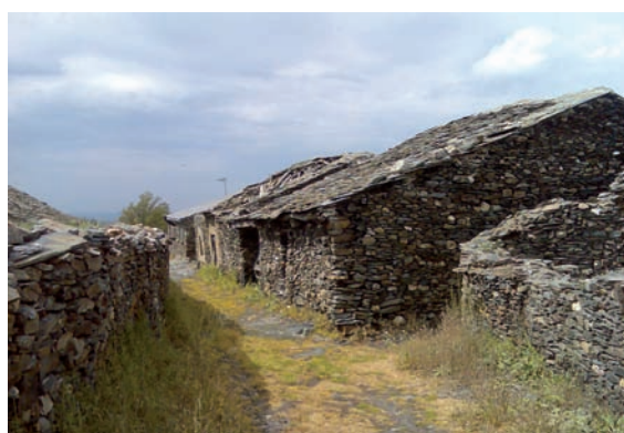
El Muyo. Viviendas. Arriba, gran chimenea troncopiramidal con reparación agresiva e irrespetuosa.
