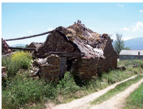
Edificio ruinoso en Lucillo que aún conserva la cubierta de teito
