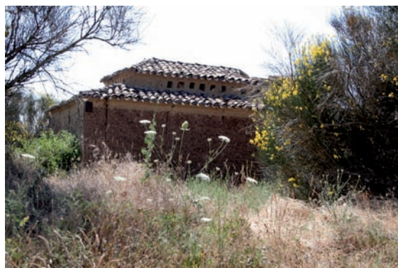
Palomar nº4, cuyo estado de conservación es el más precario
