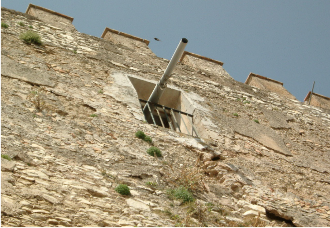
Figura 3. Evacuación de aguas de la cubierta de la Torre antes de la intervención. Fuente: Antonio González Quirós.
