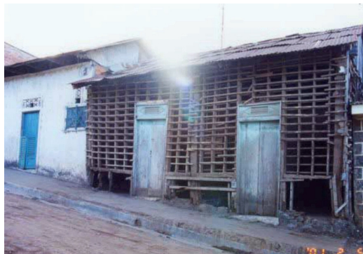
Figura 2. Enlatado fijo a los horcones después de sismo en El Salvador en 2001
