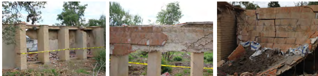
Figuras 5,6,7. Colapso del prototipo © LITEC
