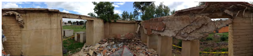
Figura 4. Colapso del prototipo © LITEC
