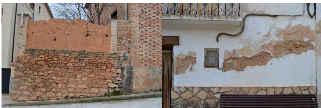
Figura 3. Tapia con pequeñas brecas horizontales y verticales desnuda en Torrebaja / Mismo tipo de tapia enlucido en Torrealta donde se ven las brecas en la parte desprendida (Vázquez-Esparza, Álvaro)
