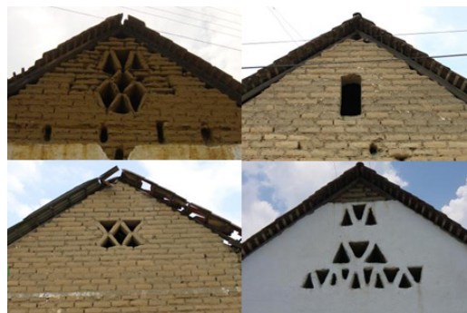
Fig. 9. Imagen de las formas variadas usadas para la ventilación de la troje. Foto: Oscar Reyes.
