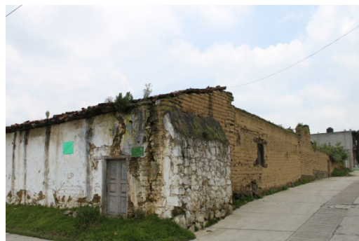
Fig. 11. Imagen de una construcción en estado de abandono y que está puesta a la venta como superficie. Foto: Oscar Reyes.
