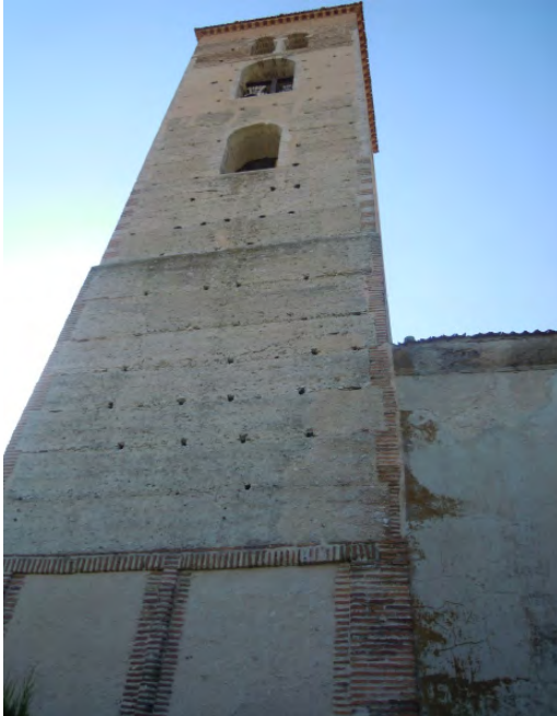
Imagen 9. Torre-campanario de la iglesia de Santa María de la Cuesta. Se aprecian los cajones de tapia.
