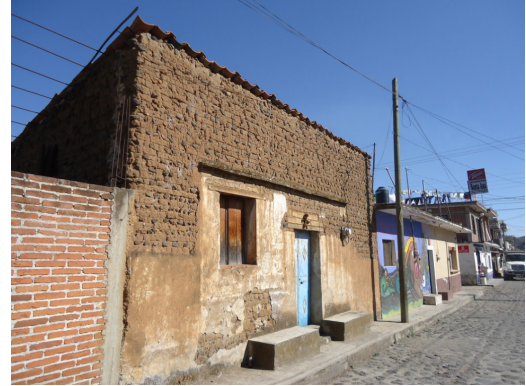
Fig. 7. En esta imagen podemos apreciar que la techumbre a "un agua" se inclina al interior del predio. Foto L. Meraz.
