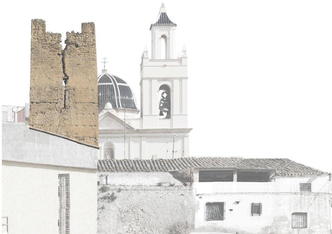
Fig. 3.- Alzado sur. Vista de la torre en su entorno, con la Iglesia parroquial al fondo. En esta fachada se aprecia su deteriorado estado actual con enormes grietas y pérdida de material. Fuente: Realización propia.
