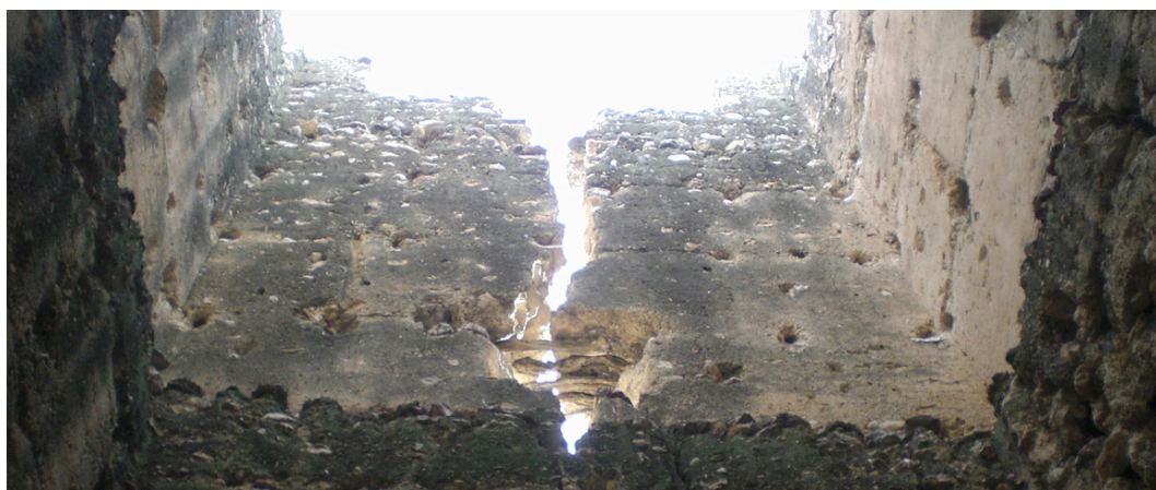
Fig. 5.- Interior de la torre. Se aprecian las marcas de las agujas para la construcción de la tapia. Se observan también cuatro redondos haciendo la función de dintel de la aspillera y que han quedado al descubierto debido a la enorme grieta de la fachada sur. Fuente: Realización propia.
