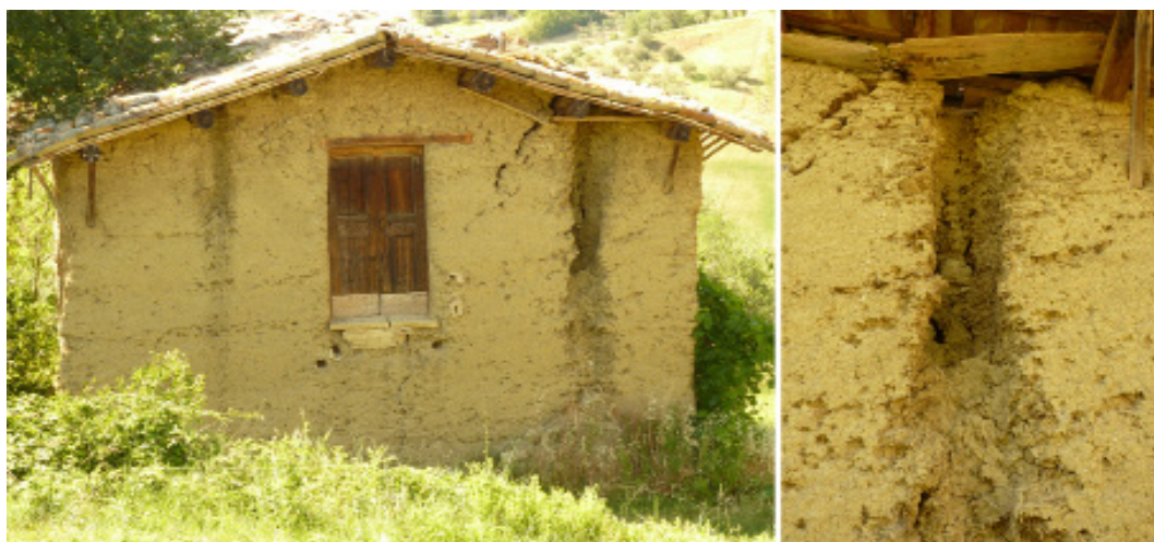
Fig. 2.- Manoppello (Pescara). Località Colle Sant'Andrea. Casa in terra cruda localizzata al centro di un podere agricolo; l'edificio è abbandonato e presenta solchi verticali scavati dall'acqua piovana, a causa del degrado della copertura che non ripara adeguatamente il fabbricato. Fonte: Claudio Mazzanti.
