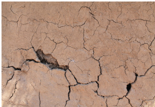
Fig. 5.- Detalle de degradación de embarrado en construcción tradicional del valle del río Luangwa, Zambia. Fuente: M.M. Barbero-Barrera Zambia. Fuente: M.M. Barbero-Barrera.
