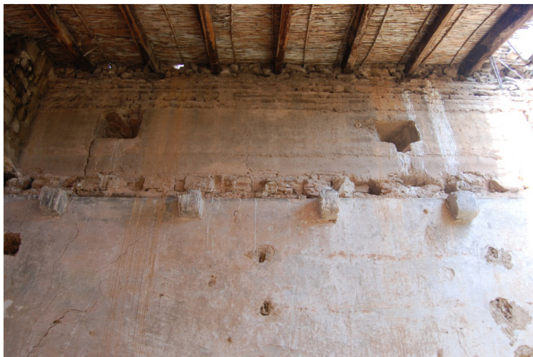
Fig. 6. Detalle de las aspilleras en el muro de tapia, donde se aprecia el recrecio del muro para recibir la cumbrera de la nueva cubierta. También se aprecian en la imagen los canes de apoyo del forjado de cubierta. Fuente: Ignacio Matoses.
