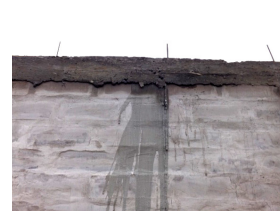
Figura 35. En el borde superior se aprecia la viga de amarre con hierros para ensamblar un sobrepiso de madera.
