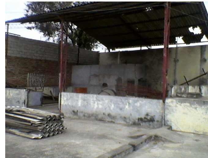
Figura 04. Infraestructura existente, en mal estado. Fuente: Estudiantes de la Facultad de Arquitectura ULEAM.
