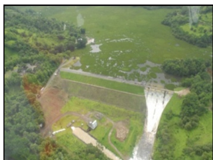
Figura 07. Represa Poza Honda evacuando exceso de agua y lechuguines.
