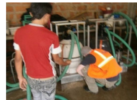
Figura 15. Planta Potabilizadora de Agua Potable para abastecer población de Chone.
