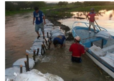
Figura 13. Zonas Agrícolas inundadas y comunidad improvisando muros.
